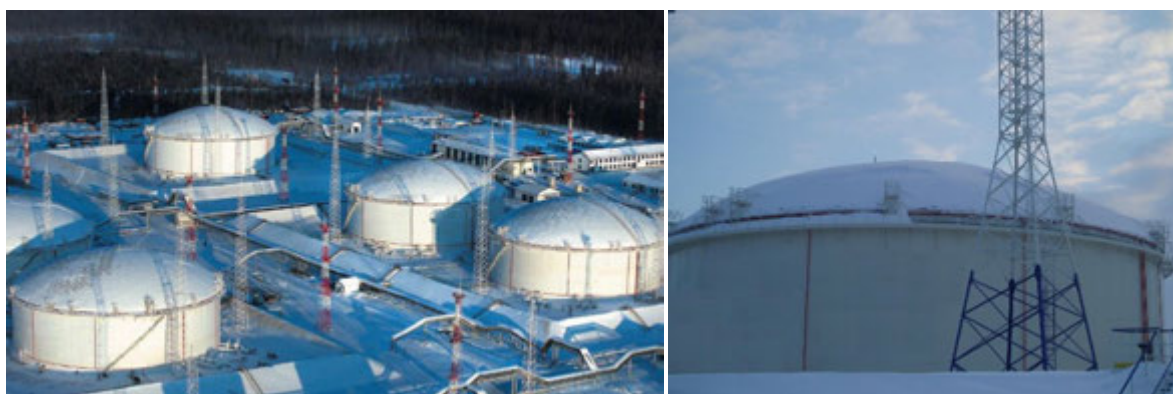
Рисунок 1. Скопление снега на крыше РВСПА-50000
